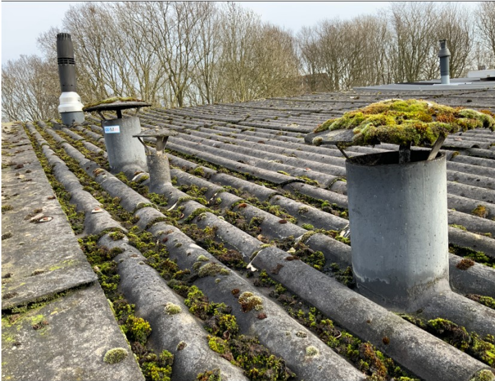
Golfplaten met dak doorvoeren van Asbest
