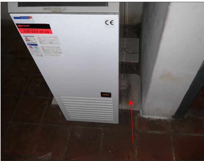
Plaatmateriaal onder cv ketel
