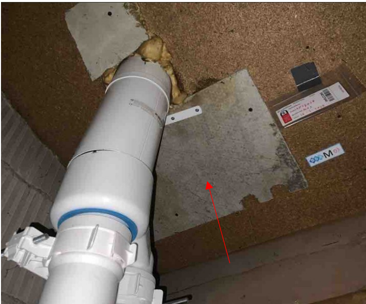
Plaatmateriaal in cv ruimte tegen het dakbeschot
