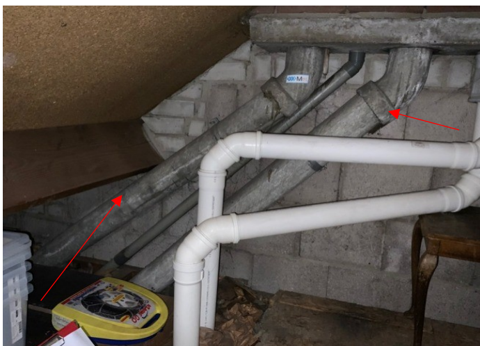
Ventilatie buizen natte ruimtes
